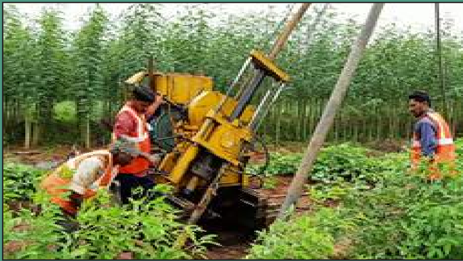
खान मंत्रालय, भारत सरकार द्वारा निकल एवं क्रोम जोन के लिए आर्बिटि ऊदुर ब्लॉक, मैसूर (जिला), कर्नाटक में किया जा रहा ड्रिलिंग कार्य।
